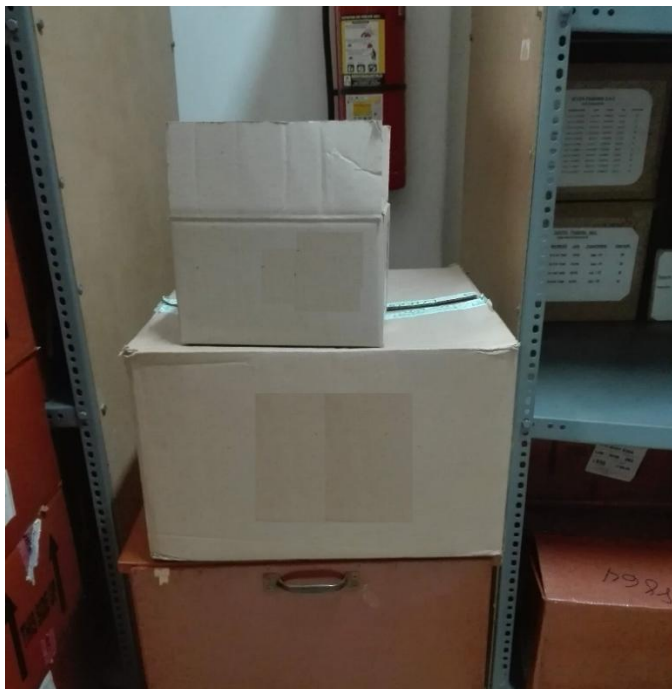
Figura 4: Cajas obstaculizando los extintores
