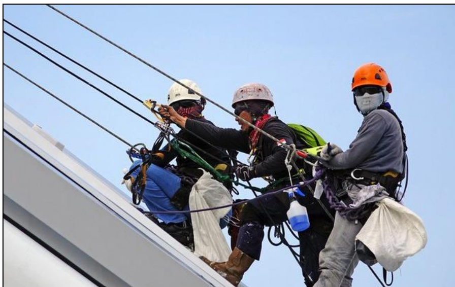
Figura 16 Protección de seguridad
